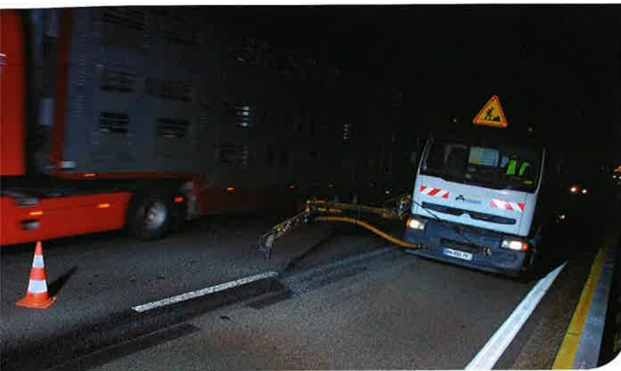
sous fort trafic, les opérations sont réalisables dans de bonnes conditions de sécurité.
